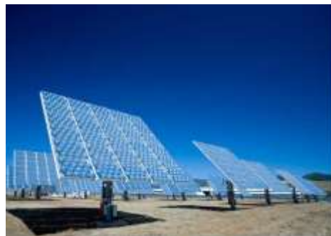
Fig. 70. Planta fotovoltaica de concentración con células de triple unión en el ISFOC de Puertollano
